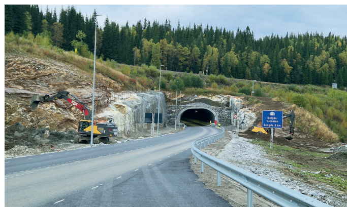
Bergsåstunnelen skulle vise seg å være vanskeligere å komme igjennom enn forutsatt.
